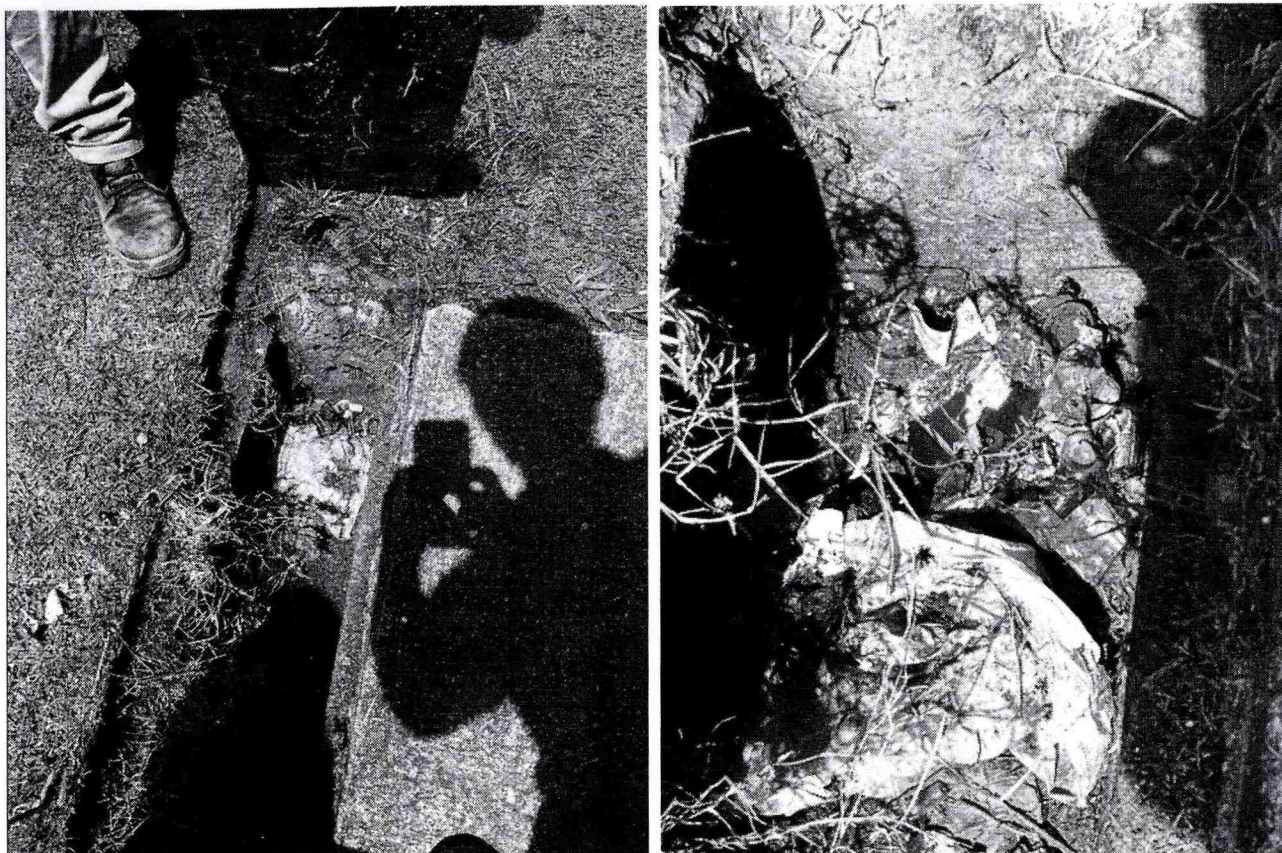
Canaletas de drenagem obstruídas por falta de limpeza
