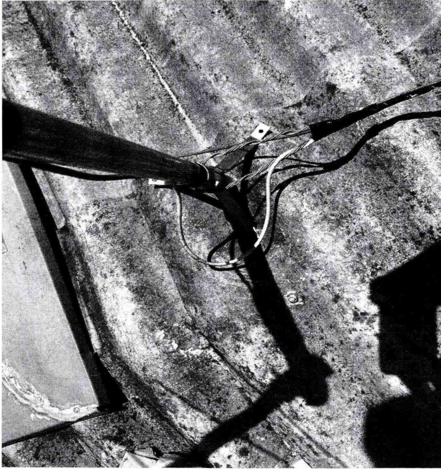
Instalação irregular de antena na onda da telha – Ponto de infiltração
