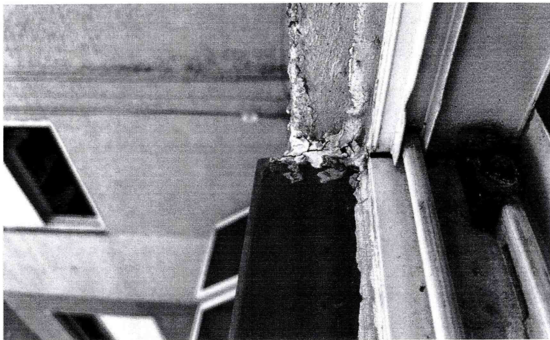
Falha no silicone da janela (falta de manutenção preventiva)
