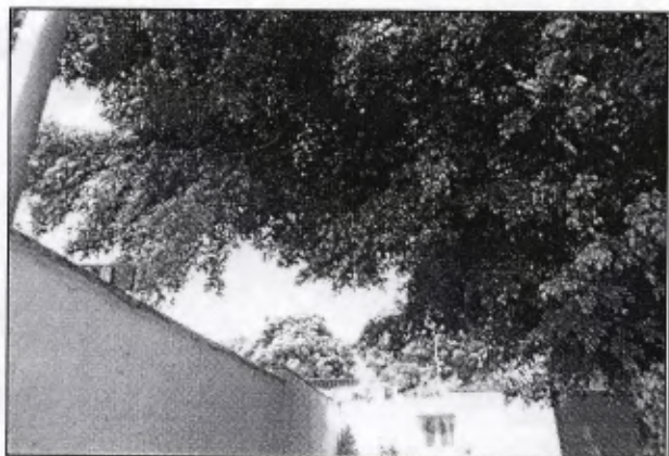
Árvore localizada nas dependências da escola. Suas raízes estão comprometendo a estrutura e a rede de esgoto do prédio. E, ainda, seus galhos estão passando para o telhado do vizinho.
