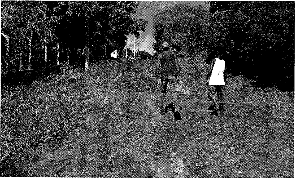
Rua totalmente intransitável – toda esburacada
