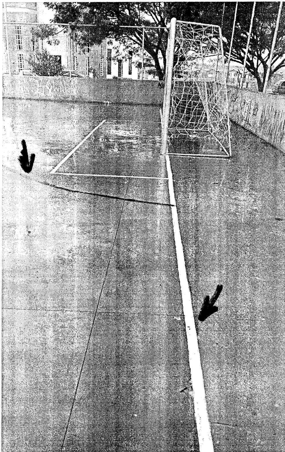
Detalhe da pintura demarcação do futsal – mal feita
