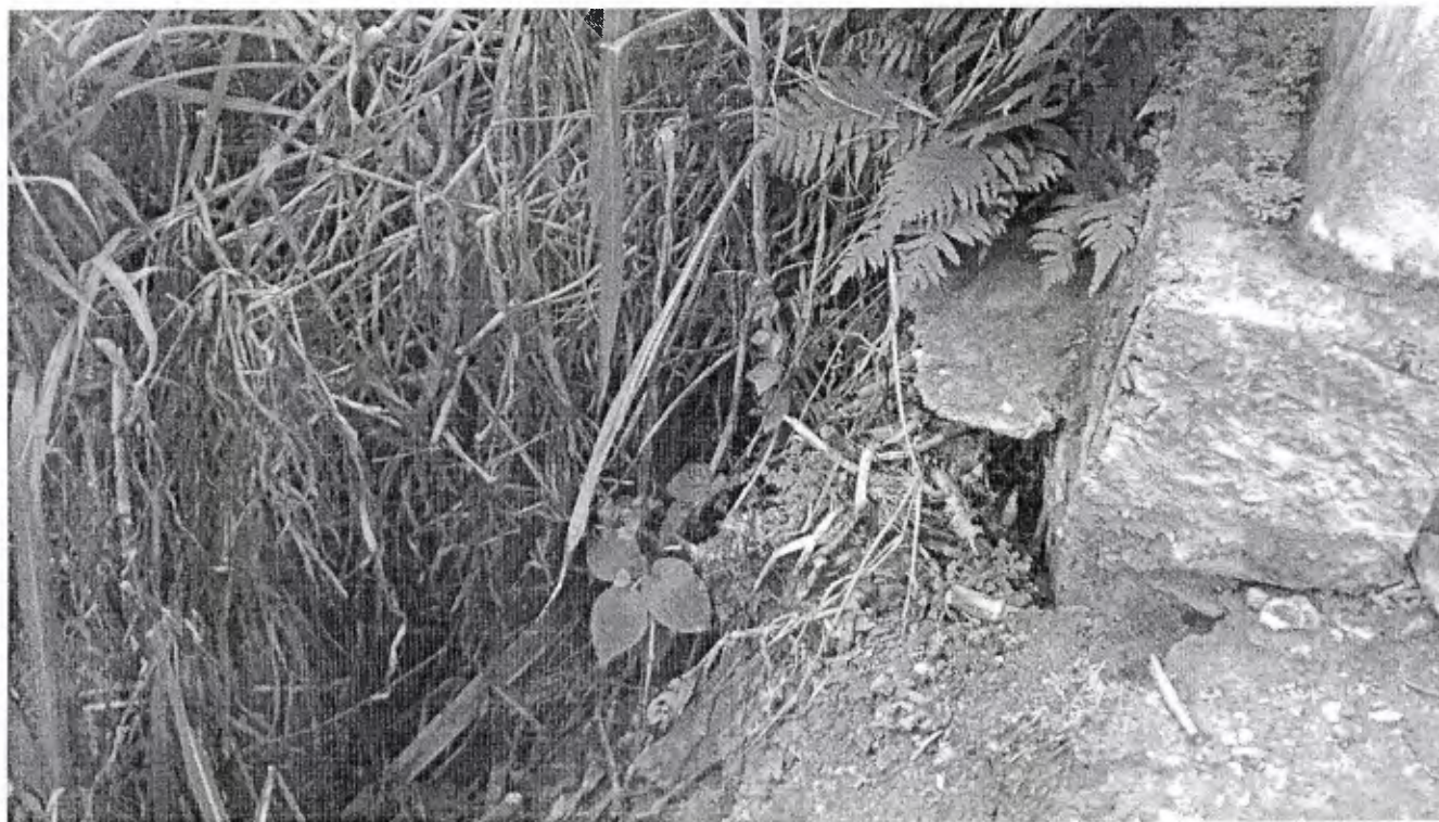
Erosão no muro da Fábrica.
