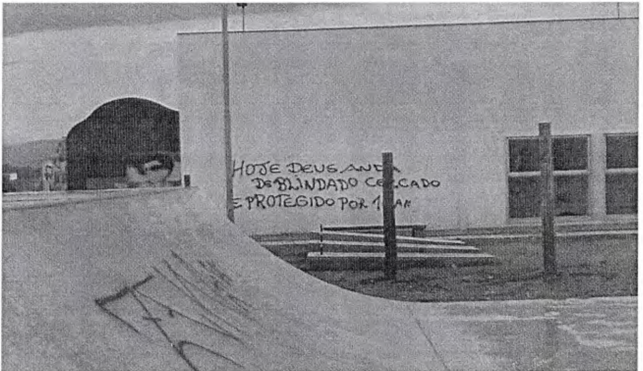
Corpo do Prédio do CEU das Artes – pichado
