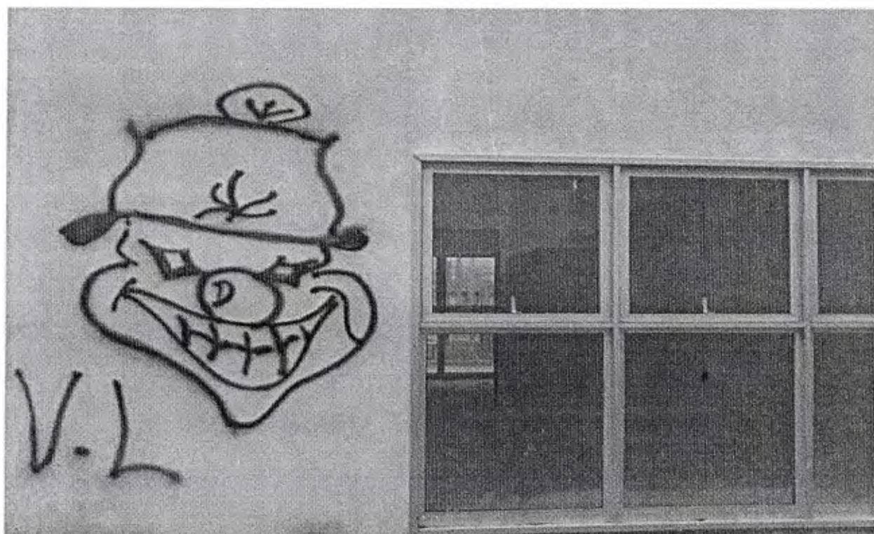
Corpo do Prédio Pichado
