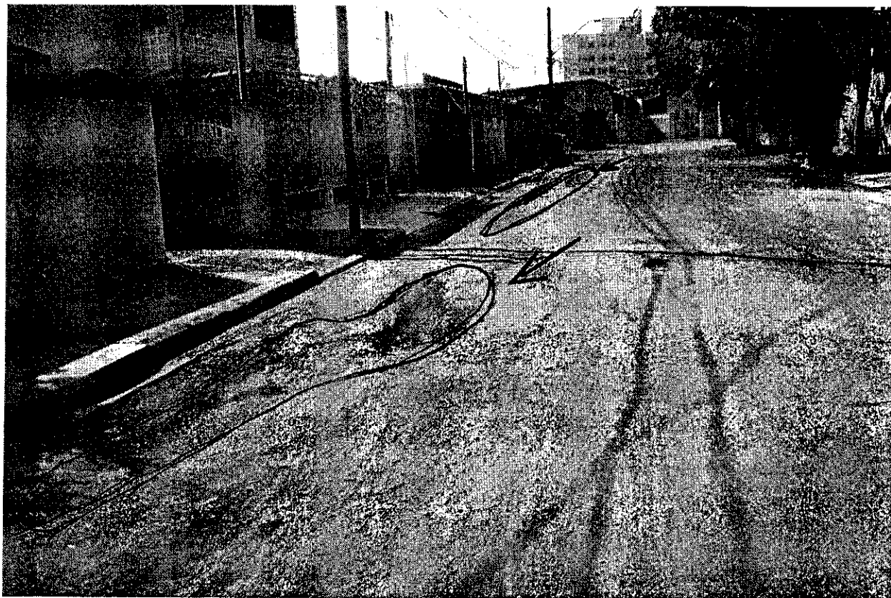
Rua Amadeu Ribeiro – Residencial Andrade Detalhe da rua sem asfalto – formação de buraco na frente da casa de morador
