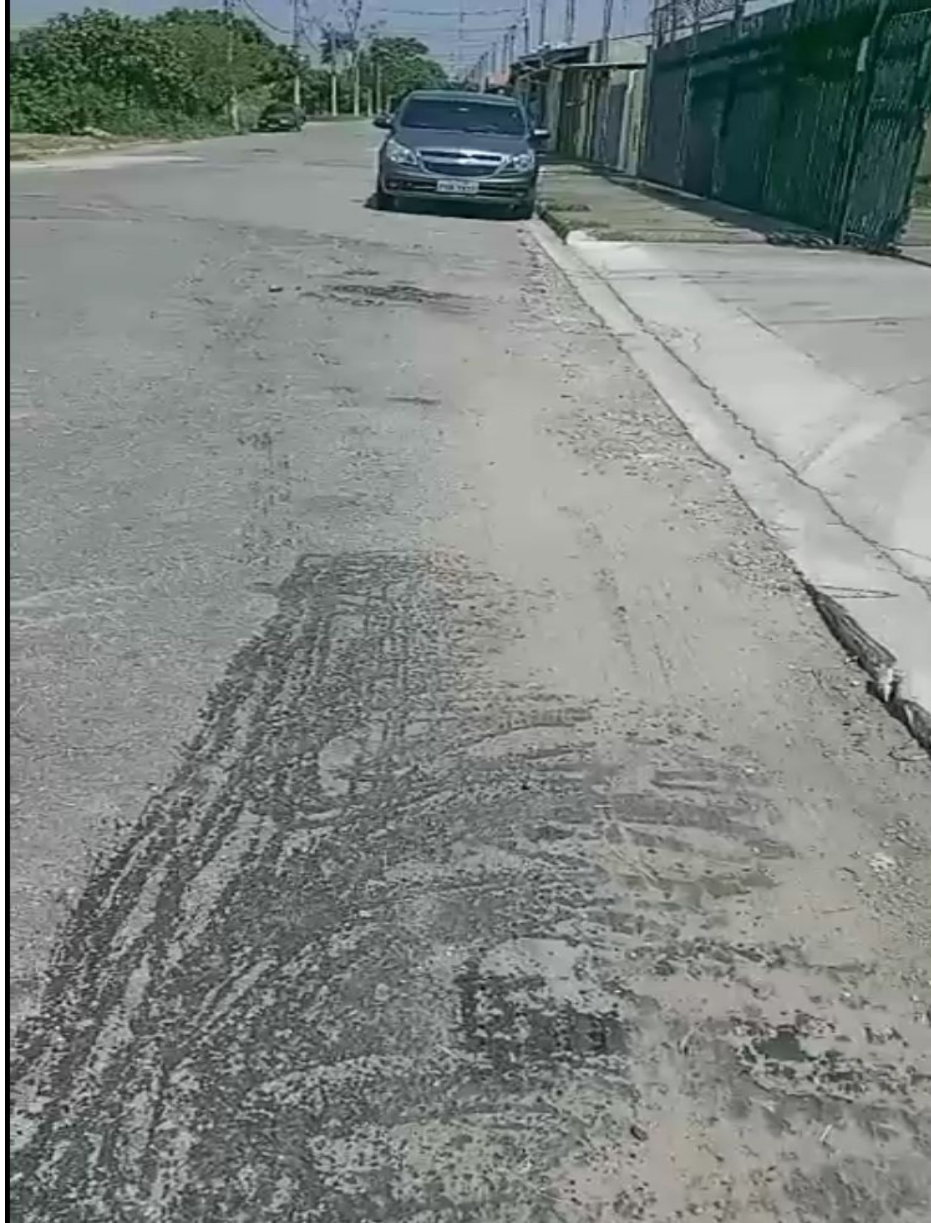
foto 2. cont. rua com remendos incompletos
