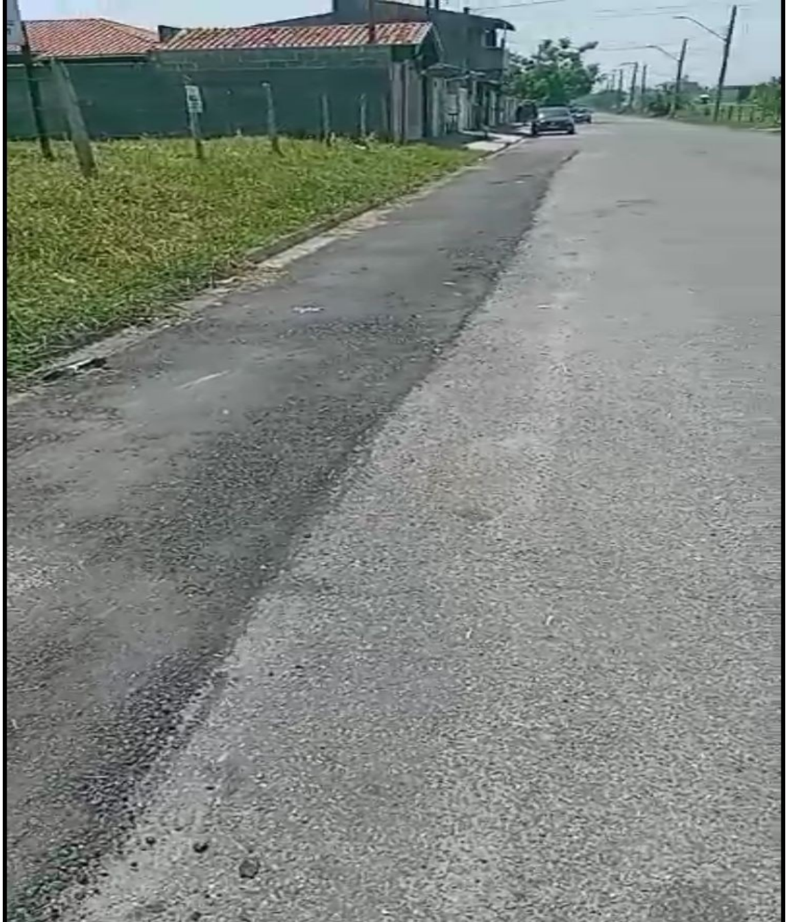
Foto 1. Rua com remendos
