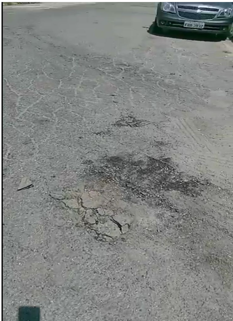
Foto 3. cont. rua com remendos incompletos e com buracos.
