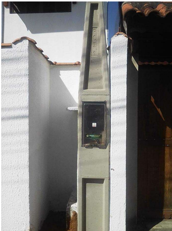
1- Poste Padrão EDP – com medidor de leitura de consumo de energia – lado externo (modelo que estava sendo utilizado até início de 2023) Somente o leitor fica do lado externo.
