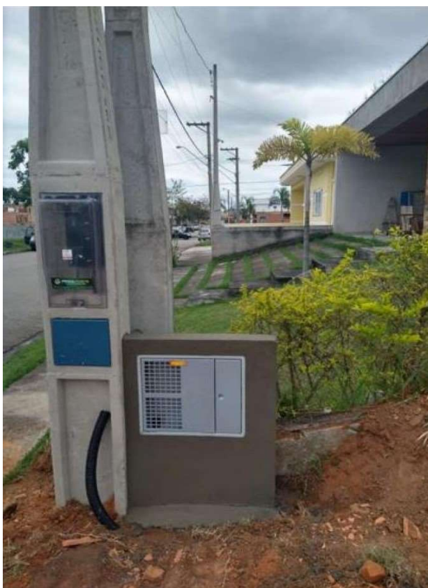
2- Poste Padrão EDP – com medidor de leitura de consumo de energia, com cx de disjuntores – lado externo (Segundo informações este novo modelo c/ a caixa de disjuntores do lado externo da casa, pode acarretar INSEGURANÇA, pois os disjuntores podem ser facilmente desligados.
